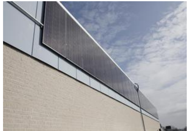
Solpaneler på sporthallens fasad i Ludvika där 175 kW traditionella solpaneler installerats.
